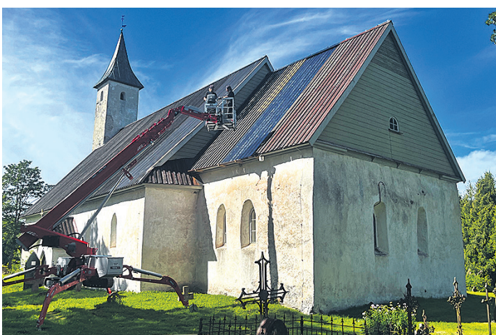
Kiriku katuse remondi vajadus selgus mullu, kui seda tõrvama hakati.
