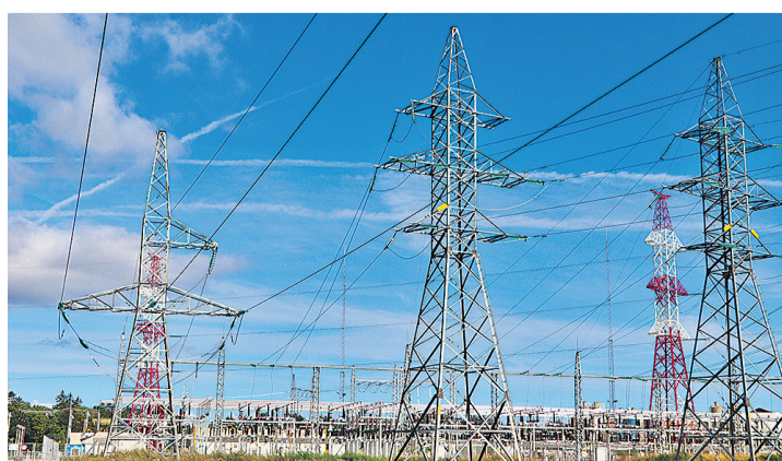
Lihula alajaam ühendati 330 kV kõrgepingeliiniga.
